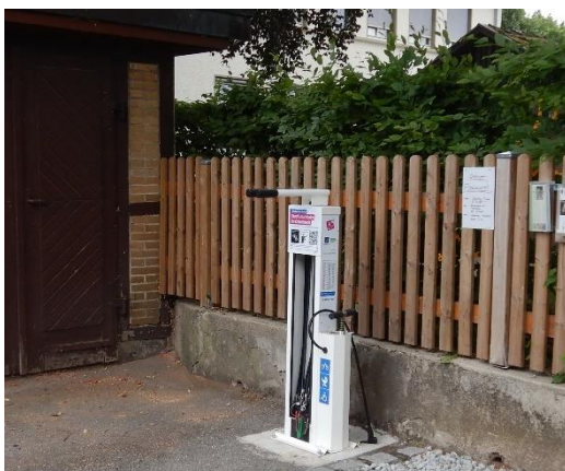
Abbildung 31: Reparaturstation am Parkplatz Treffpunkt Bären – Stiftungshaus für Vereine und Soziales
