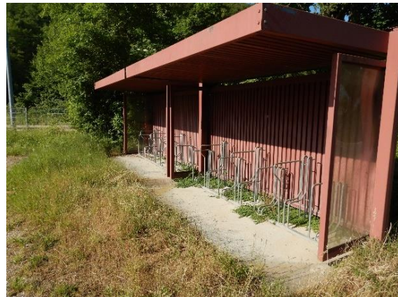
Abbildung 4: Zustand der Abstellanlage am Bahnhof Lauchheim
